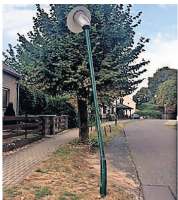
Diese Lampe in Grüneberg wurde beschädigt. FOTO: GEMEINDE
